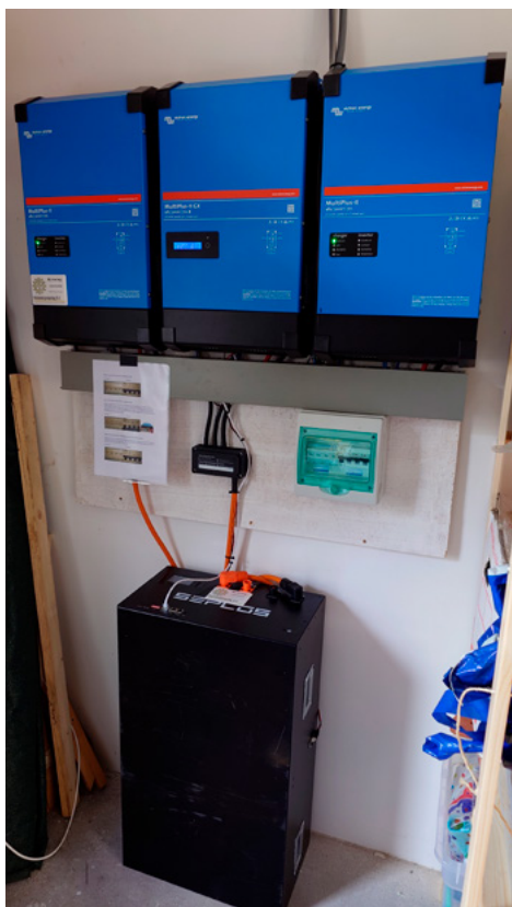
3-fase installatie met 15kWh capaciteit met noodstroomvoorziening
