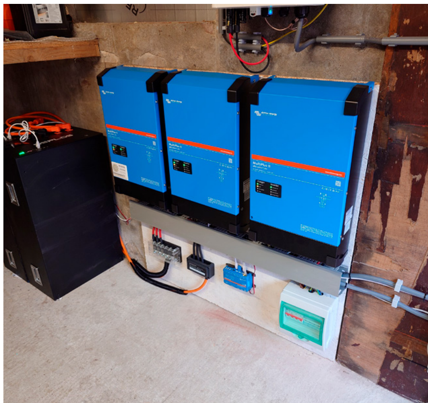
3-fase installatie met 30kWh capaciteit met noodstroomvoorziening
