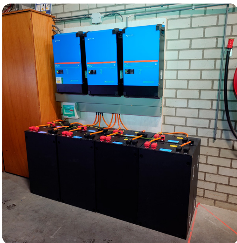
Figuur 2 - Bedrijfshal voorzien van een 3-fase installatie 120kWh, met noodstroomvoorziening
